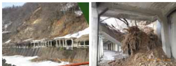
図 3.5 背後の斜面の表層崩壊によるスノーシェッドの崩壊(長野県栄村横倉)
