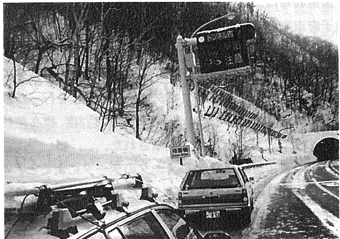
図2 広尾側雪崩発生のり面(1998年1月26日撮影)
