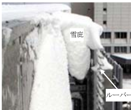
写真2 雪庇による外壁ルーバーの損傷状況
