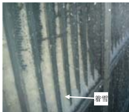
写真1 首都圏における高層建築物の壁面凹凸部への着雪
