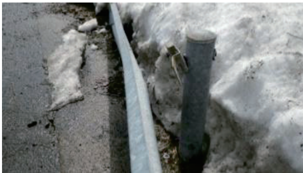
写真1 ガードレールの脱落事例 [1]
