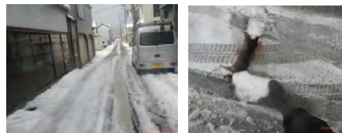
図 4 消雪パイプの機能が低下している道路と接合部が破断された消雪パイプ (富山県氷見市)。
