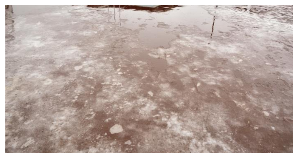
図 2 道路上の氷板に生成した斑点(北海道函館市)
