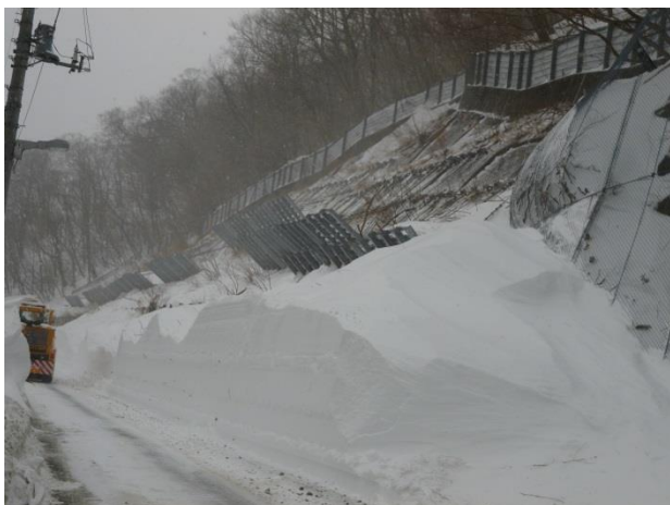
写真-1 雪崩発生後の防雪施設の状況（2月16日）
