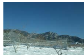
図7 山梨県農業用ハウス倒壊
