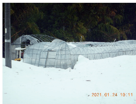
図2 ビニールハウスの倒壊(上越市)
