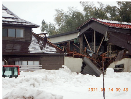
図1 建物の倒壊(上越市)
