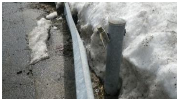
写真1 ガードレールの脱落事例 [1]
