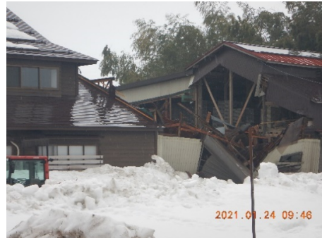
図 1 建物の倒壊(上越市)
