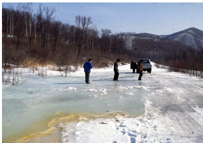
写真 9-01 涎流水-1- 道路沿いの排水溝を乗り越えて道路を覆った涎流水.
