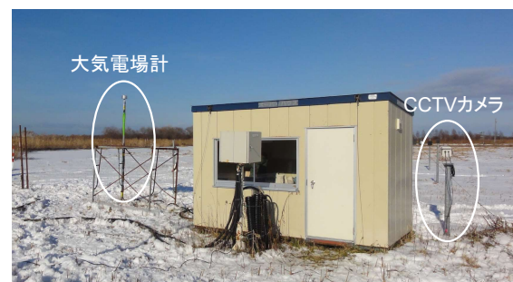
図2 大気電場計とCCTVカメラの設置状況
