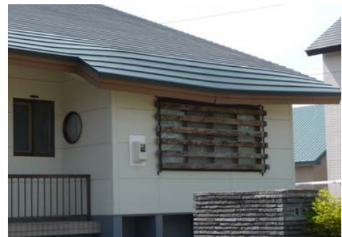
写真1 軒損傷の事例
