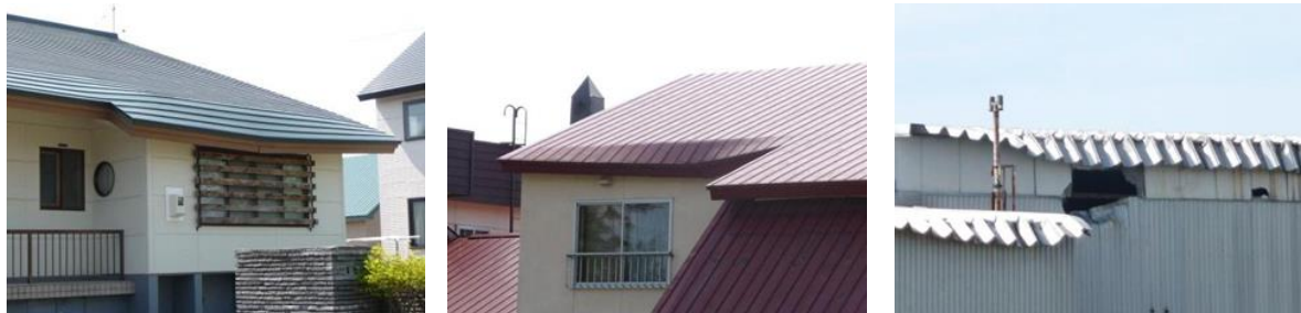
写真 1 豪雪後における軒部損傷の事例
