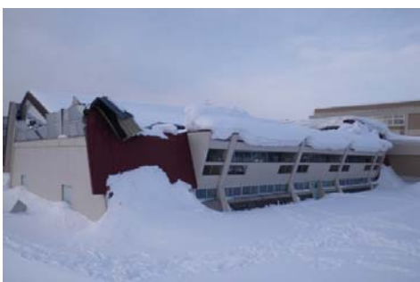
図-7 鉄骨造体育館の倒壊被害(旭川市)
