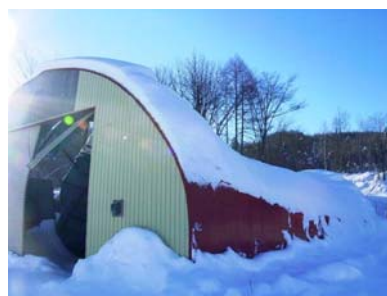
図-10 D型ハウスの被害
