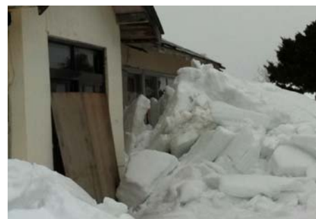
図-8 屋根雪による空き家の破損
