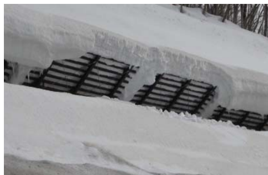
写真-2 融雪期による雪庇型巻きだれの破断
