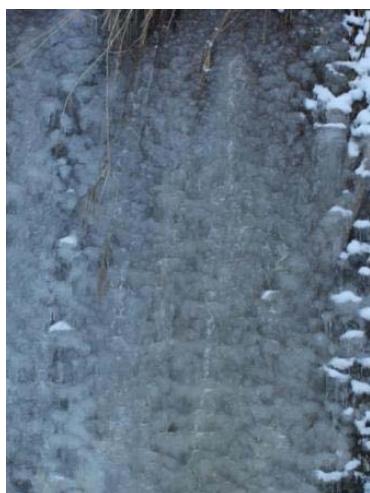
図9 2010年12月28日15時 波状氷面 (2号床固工ダム堤体、 中央部、縦2m横1.5m)
