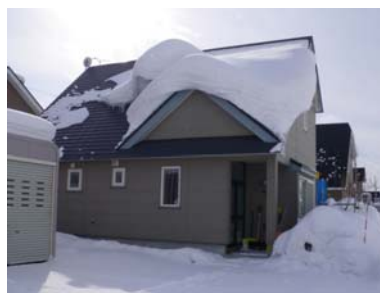
写真-2 落雪屋根の落雪障害
