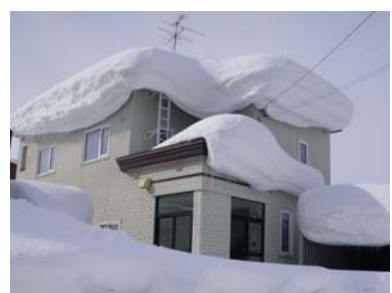
写真-3 無落雪屋根の雪庇
