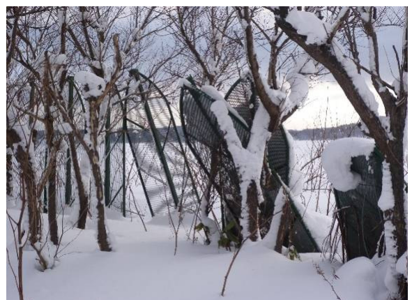
写真-5 フェンスの破損状況
