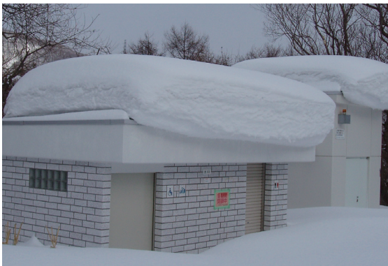
写真1 平屋根にクリープでできた雪庇
