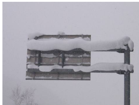
図1 道路案内標識の冠雪事例
