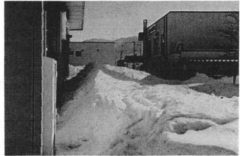
写真2 軒下堆積雪による外壁材の劣化
