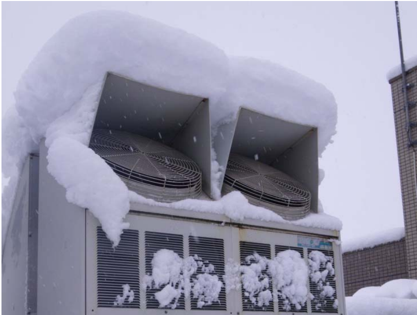
空調機器への冠雪、吹き込み
