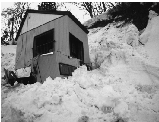
図 9 地震による雪崩によって被災した建物（新潟県十日町市）。
