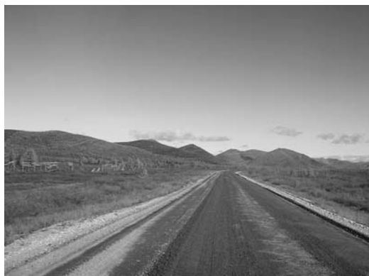
図 9 コリマ街道沿いに設置された防雪柵。道からやや離れた奥の写真左中央付近に壊れた防雪柵が見える。
