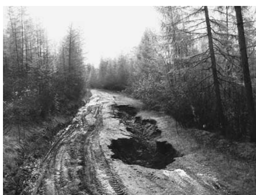
図 11 ひび割れたコリマ街道。
