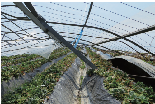
写真 5 角形鋼管でできた柱と基礎が倒壊した小山市飯塚のイチゴ栽培用温室。(4 月 11 日 森山英樹撮影)
