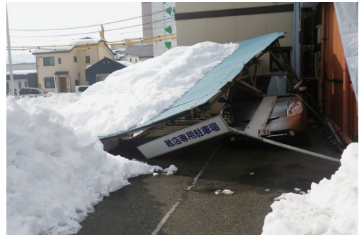
写真 4 柱脚の破損により屋根が倒壊した甲府市内の駐車場。(2 月 19 日 上石 勲撮影)
