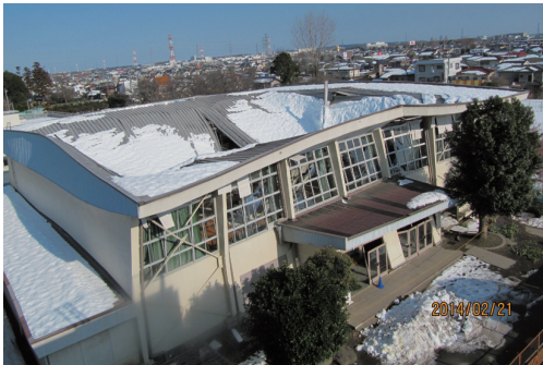
写真 3 湿った積雪の荷重により屋根の崩落した青森市内の中学校の屋内運動場。(2 月 21 日 高橋 徹撮影)
