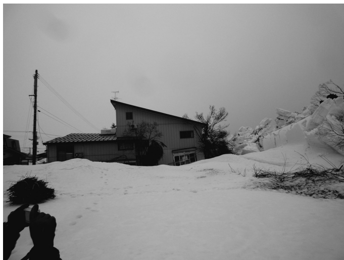
写真 2 土塊（写真範囲外右側）に押し出された雪塊による雪圧で家が変形を始めている様子（3 月 10 日）
