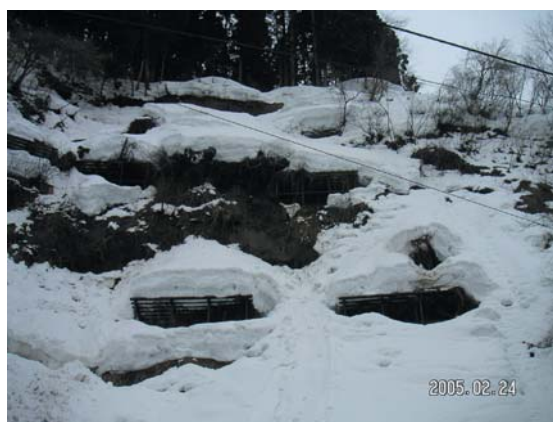
写真 3 斜面, 雪崩防止柵が地震で傷み, そこに豪雪が加わり, いたるところで小規模雪崩が発生 (長岡市蓬平町, 2005 年 2 月 24 日撮影)。
