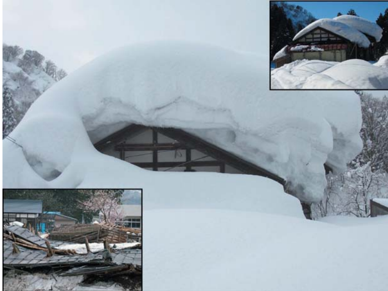
写真 1 全村避難が続く山古志村（現長岡市）で、豪雪に耐え切れず押し潰された家 （右上 2005 年 1 月 29 日，中央 2005 年 2 月 12 日，左下 2005 年 4 月 29 日撮影）。
