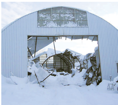
写真 2. 雪の重みで屋根が抜け落ちた D 型ハウス
