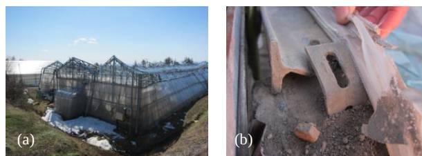
写真4 ガラス室のラチス梁と柱基礎接合部の破壊
