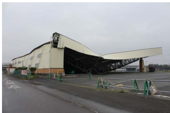
写真 大型鉄骨造建築物の被害
