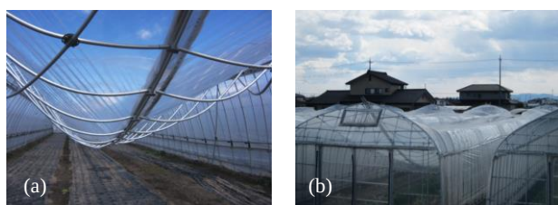
写真1 単棟パイプハウスの屋根の陥没
