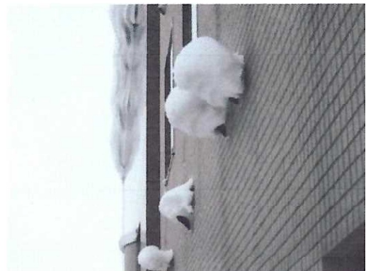
写真1 換気口への着雪
