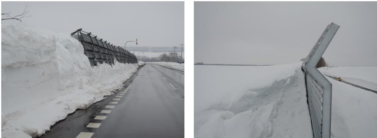
図 1 防雪効果を失った吹き払い柵(左)と吹き止め柵(右)※2015 年 3 月 20 日中標津町
